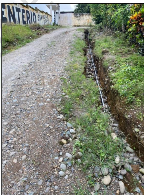
Figura 7. Erosión vial por causa invernal y carencia del alcantarillado pluvial (Marujita). Fuente. MONTESDEOCACORP S.A. 2021.
